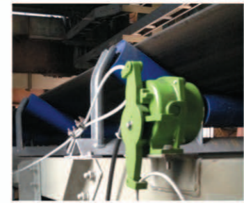
コンベヤ非常停止用 非常引綱スイッチ
