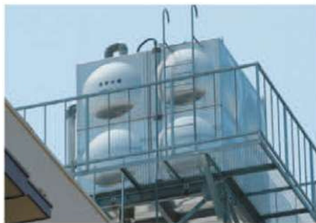
給水タンク、高架水槽
