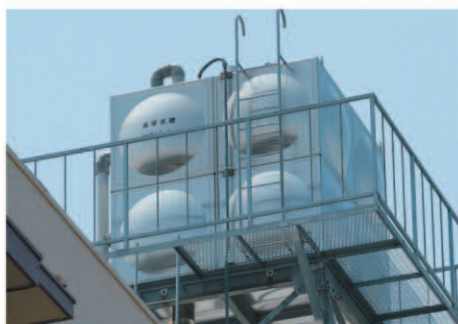
給水タンク、高架水槽
